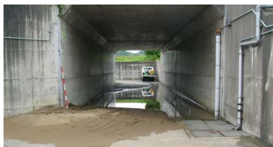
写真-5.37 刈羽村滝谷交差点 C-BOX での噴砂跡 （刈羽村では、広域的に液状化が発生していた）
