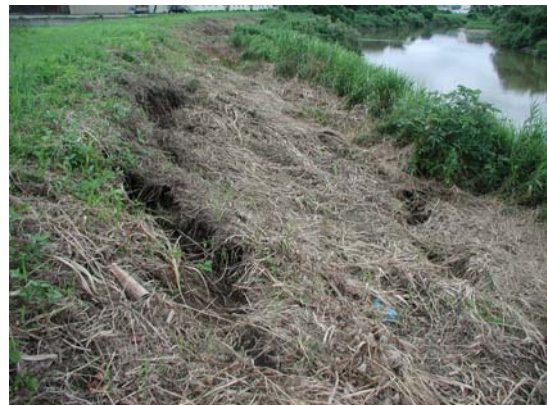
写真-5.15 鯖石川右岸堤防でのクラック発生状況
