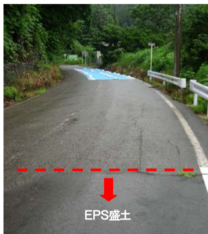
写真-6.12 EPS盛土No. 2近傍 (終点側) 隣接箇所での道路変状状況
