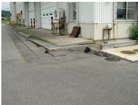
写真-6.16 刈羽村農道の上記変状箇所に隣接する建屋での液状化による地盤沈下状況
