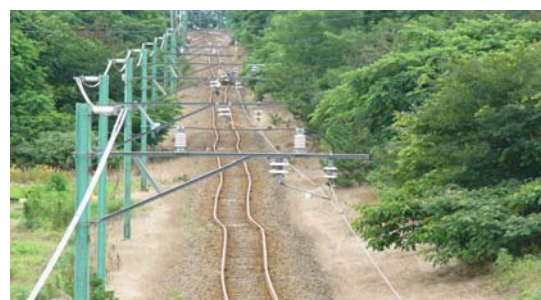
写真-5.36 刈羽陸橋からの線路の変状状況
