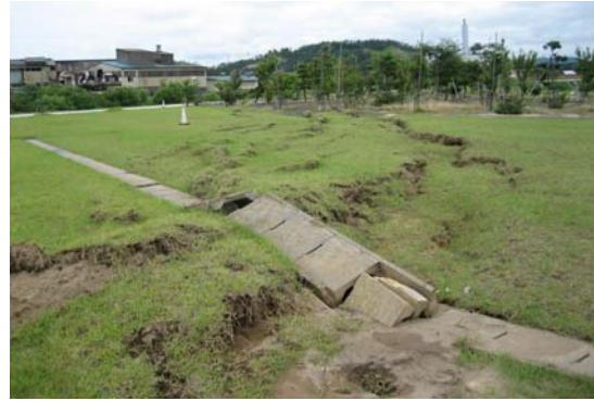
写真-5.12 記念公園盛土での液状化による変状 ( 広大な公園内で直線的に変状が発生 )
