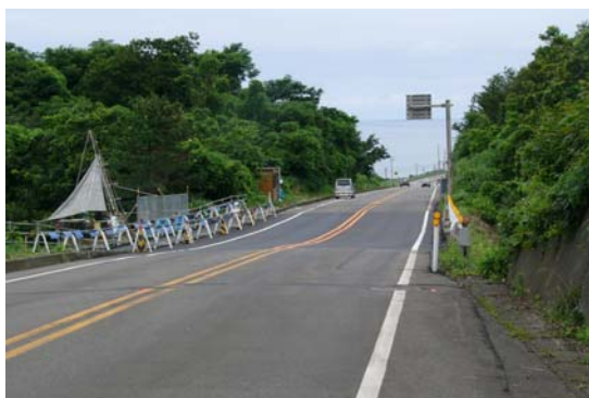
写真-5.34 柿崎区・国道8号の道路陥没状況
