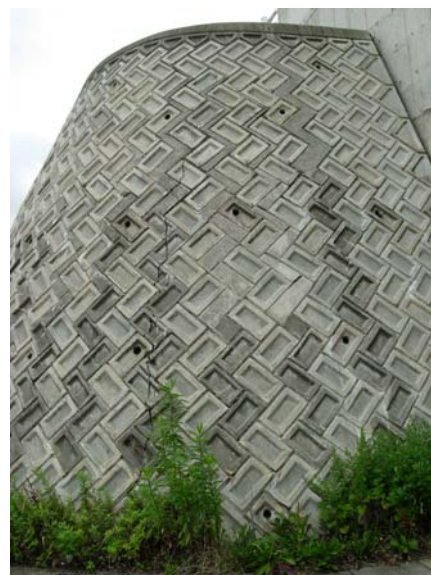
写真-6.18 国道8号半田地区跨線橋橋台背面E P S盛土 (両直型E P S盛土側面の土盛土壁面にクラック)
