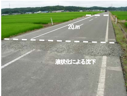
写真-6.14 刈羽村農道E P S盛土の変状 (基礎地盤の液状化による地盤沈下による変状)
