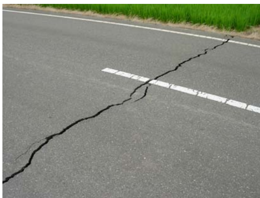
写真-6.15 刈羽村農道E P S盛土の道路横断クラック (上の写真での奥の点線部：クラック幅は4cm程度)
