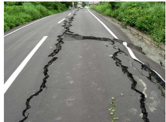
写真-5.21 鯖石川右岸堤防に隣接する道路の崩壊
