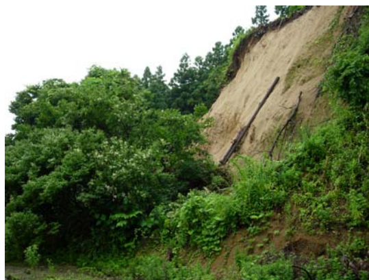
写真-6.6 出雲崎町小釜谷中永線の道路拡幅EPS盛土 (No.1) EPS盛土背面地山の斜面崩壊状況
