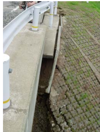
写真-5.13 公園内・平成大橋のアバット部分の沈下
