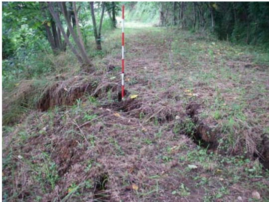
写真-5.17 鯖石川右岸堤防でのクラック発生状況
