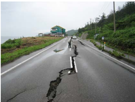
写真-5.10 国道352号大湊地区の路面状況
