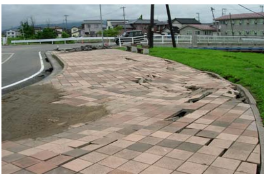
写真-5.11 鯖石川改修記念公園での液状化による変状
