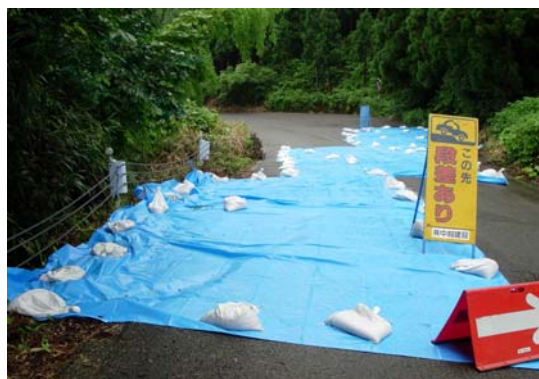
写真-6.7 EPS盛土No.1近傍(始点側) 隣接箇所での道路盛土変状状況
