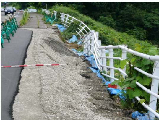
写真-5.3 県道393号礼拝長岡線の路肩崩壊
