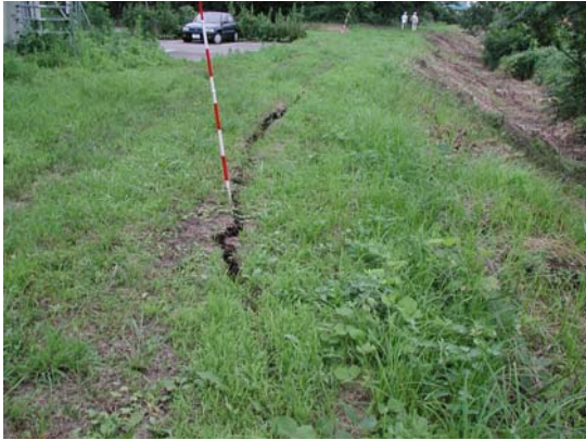
写真-5.16 鯖石川右岸堤防でのクラック発生状況
