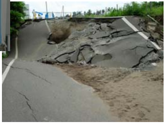
写真-5.20 『クリーンセンターかしわざき』の煙突損壊・すべりによる路面陥没（陥没量 250cm）
