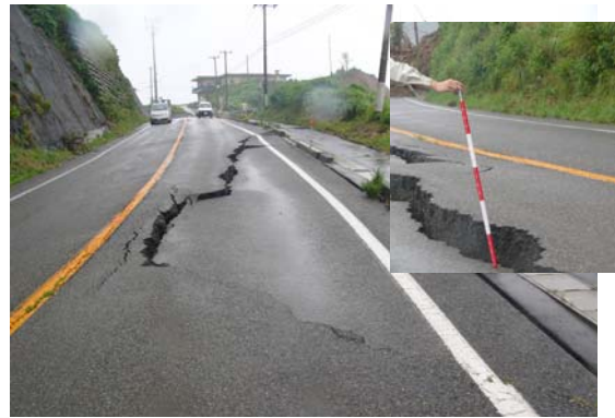
写真-5.4 国道352号椎谷地区の路面陥没
