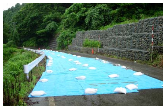
写真-6.11 EPS盛土No. 2近傍 (始点側) 隣接箇所での道路変状状況
