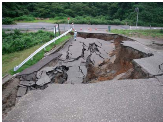
写真-5. 30 国道8号沿い道路の谷埋め盛土の崩壊
