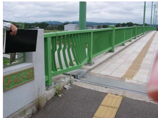
写真-5.14 公園下流側の平成大橋での変状
