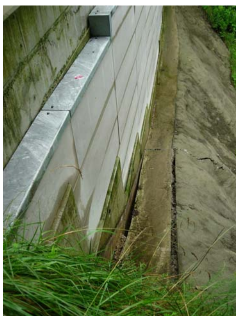
写真-6.3 出雲崎町小釜谷中永線の道路拡幅EPS盛土 (No.1) EPS盛土は健全であったが隣接地山ですべりが生じEPS盛土前面に変状
