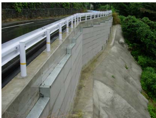
写真-6.8 出雲崎町小釜谷中永線の道路拡幅EPS盛土 (No. 2) 壁面状況
