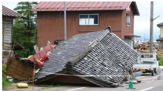
写真-5.35 刈羽村で多く見られた家屋の倒壊
