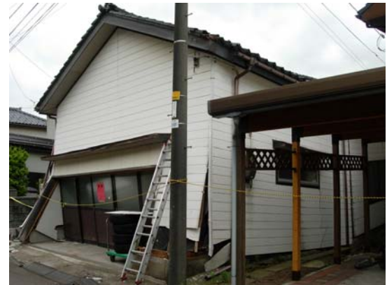
写真-5.22 山本地区における家屋の被害状況
