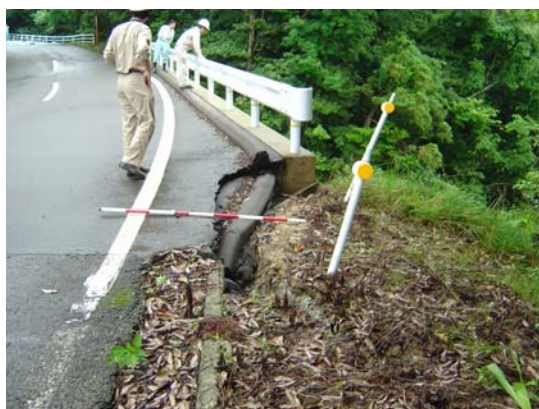
写真-6.5 出雲崎町小釜谷中永線の道路拡幅EPS盛土 (No.1) 隣接地山でのすべり発生状況
