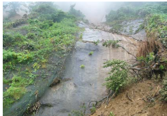
写真-5.7 国道352号の斜面崩壊（すべり面） （すべり面が非常に明確に確認される）
