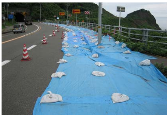
写真-5.31 上輪地区・国道8号ののり面崩壊 【米山町】
