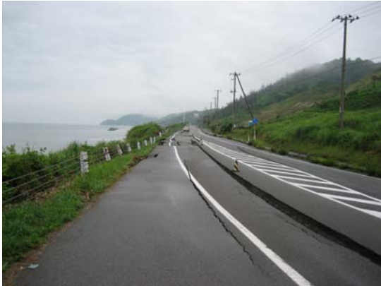
写真-5.8 国道352号大湊地区の路肩すべり
