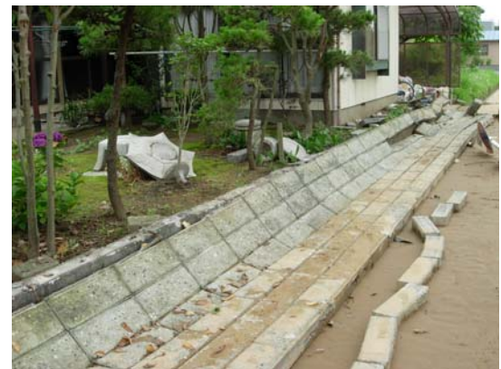
写真-5.23 松波地区におけるブロック塀の損壊
