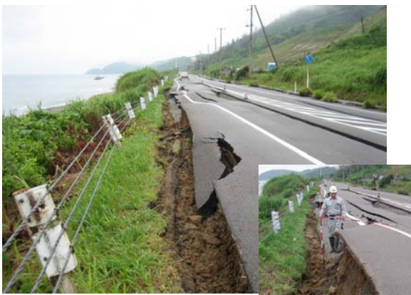
写真-5.9 国道352号大湊地区の路肩崩壊
