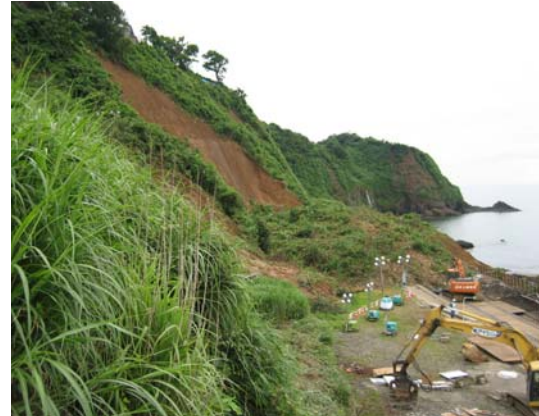
写真-5. 27 J R信越本線青海川駅の斜面崩壊復旧状況 【 笠島地区 】
