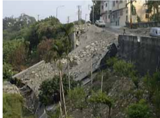
写真-6.13 石岡地区の豊勢路道路の脇道（隆起量2m）
