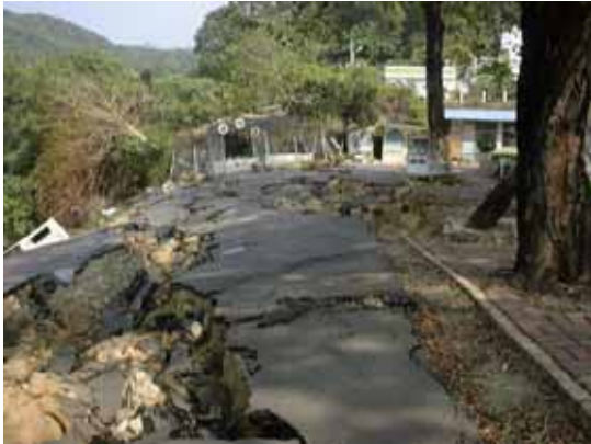
写真-6.10 軍功国中小学校グラウンドのすべり崩壊
