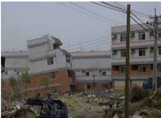
写真-6.1 地震断層により被害を受けた建物 (豊平地区・豊勢路二段沿い)
