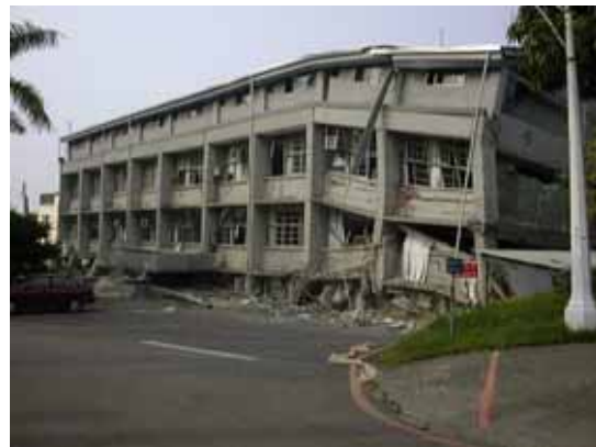
写真-6.4 1階部分が崩壊した台湾省の図書館
