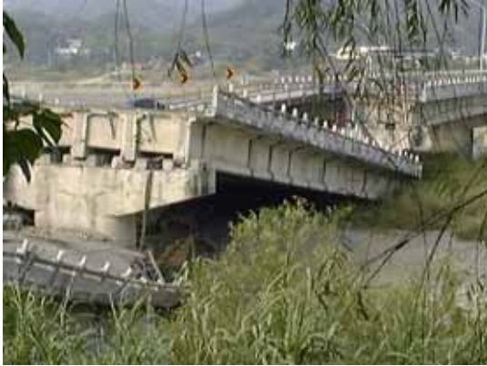
写真-6.5 長夷大橋（石岡地区）の落橋
