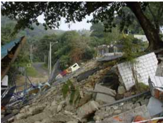
写真-6.11 断層上の擁壁が隆起し転倒することにより生じた斜面のすべり崩壊状況
