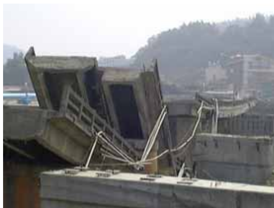
写真-6.7 一江橋（大平地区）の落橋
