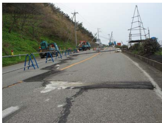
写真-5.3 輪島市深見町地内の国道249号路面陥没
