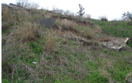
写真-5.4 輪島市深見町地内の国道249号の斜面崩壊
