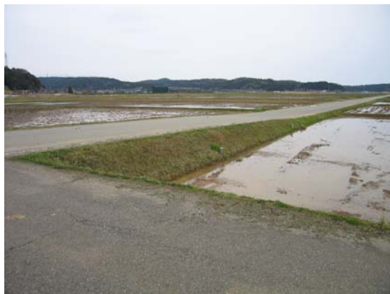
写真-6.15 七尾市農道(中島町) EPS盛土の路面状況
