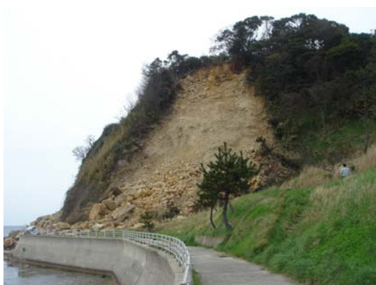
写真-5.1 輪島市袖ヶ浜海岸沿いの斜面崩壊 （凝灰質シルト岩の風化面に沿った崩壊）
