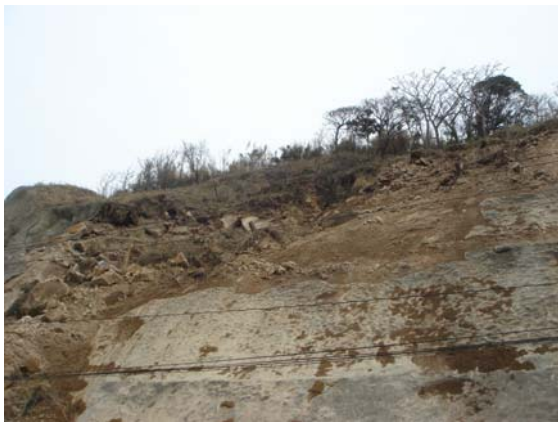
写真-5.7 輪島市大川町地内の国道249号の斜面崩壊
