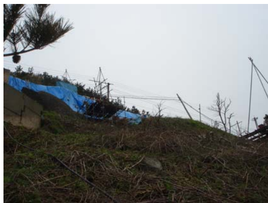
写真-5.5 輪島市深見町地内の国道249号の斜面崩壊
