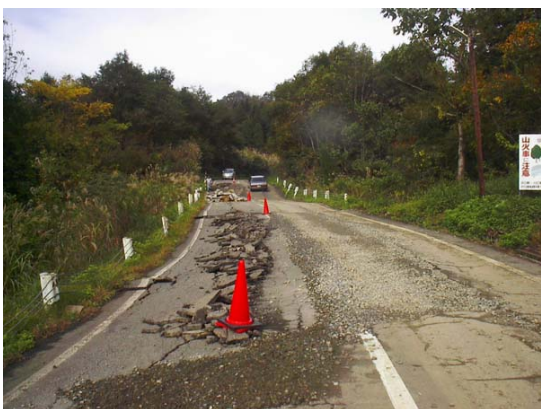
写真-5.30 切盛り境からの沈下・路面変状
