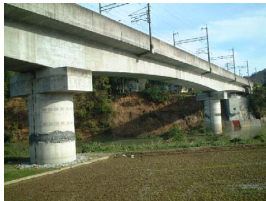
写真-5.25 J R新幹線と南津地区橋梁の橋脚座屈
