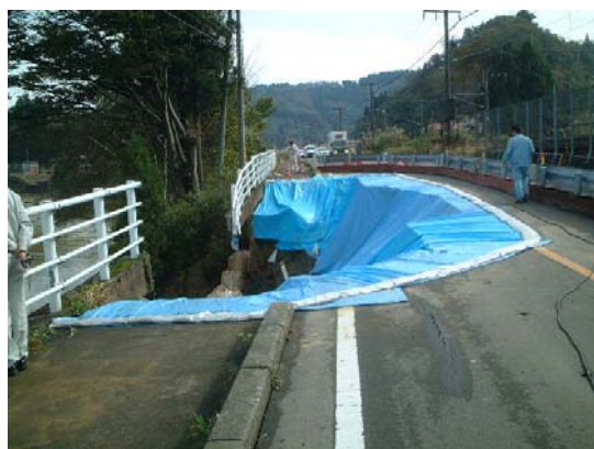
写真-5.12 国道404号越路町付近の道路盛土の崩壊
