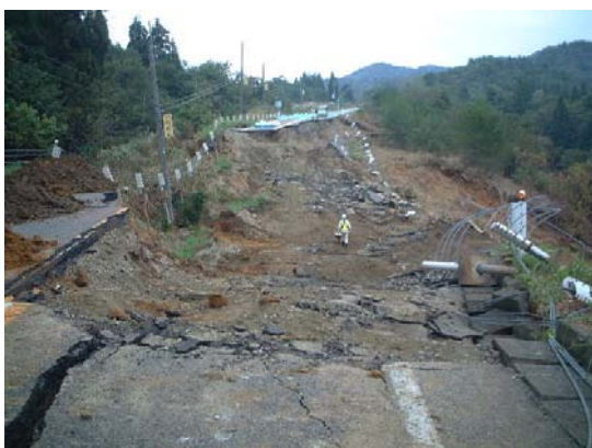
写真-5.8 国道351号宮路町付近のすべりによる崩壊
