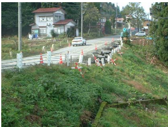
写真-5.21 国道117号川口の道路盛土のすべり崩壊
