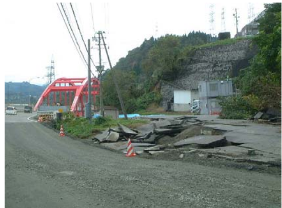
写真-5.19 国道117号上片貝山辺橋の橋梁基礎斜面のすべりによる橋台背面盛土・橋台基礎・橋脚の変状
