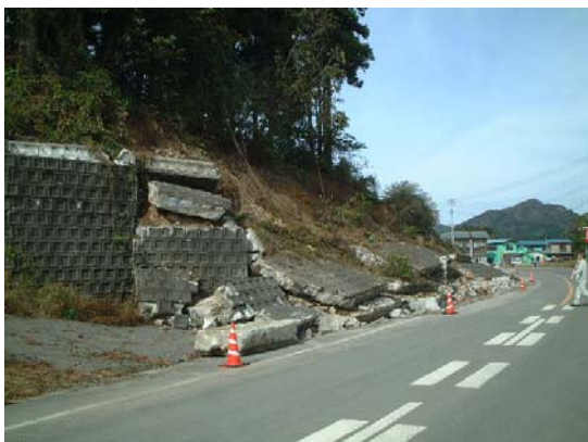
写真-5.22 国道117号川口の道路斜面の擁壁崩壊
