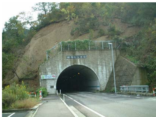
写真-5.14 国道291号桜町トンネル坑口斜面の表層すべり
