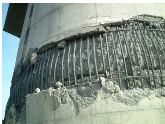
写真-5.26 J R新幹線と南津地区橋梁の橋脚座屈
