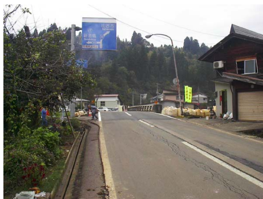
写真-5.39 橋梁取付け部の沈下と応急擦り付け状況
