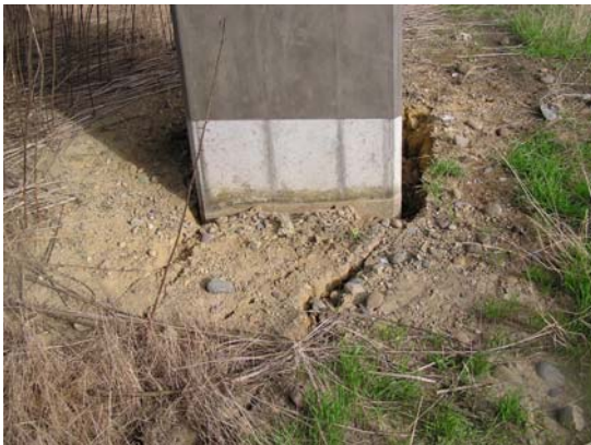
写真-5.17 長岡市内新幹線橋脚と基礎地盤部の隙間 （震動によって橋脚が左右（横断（東西）方向）に揺さぶられ、基礎地盤との間に隙間が発生）
