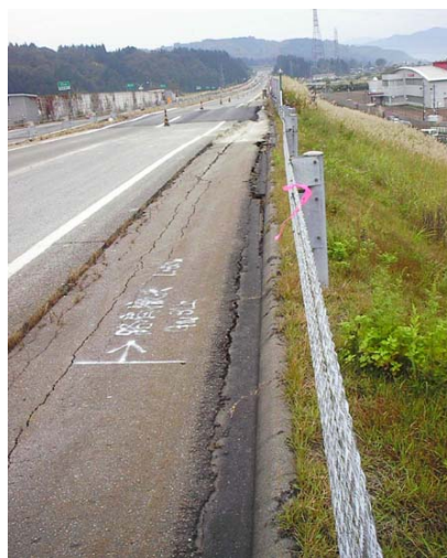
写真-5.33 関越道：液状化・のり肩からのすべりとBOX背面盛土の沈下に伴う応急復旧（擦り付け）
