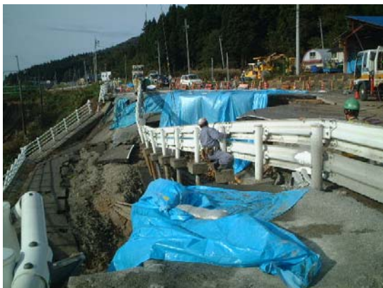
写真-5.23 国道17号津山町付近の道路盛土の崩壊
