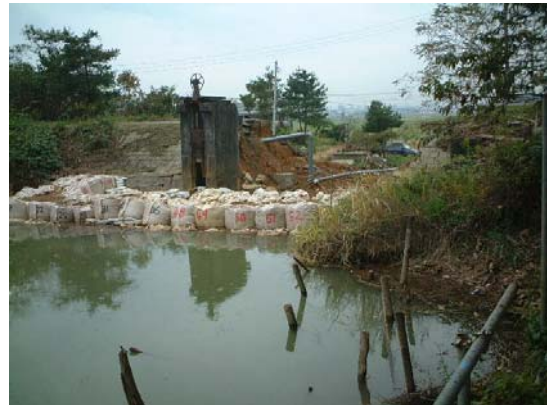
写真-5.4 長岡市内のへら鮎池堰堤の崩壊
