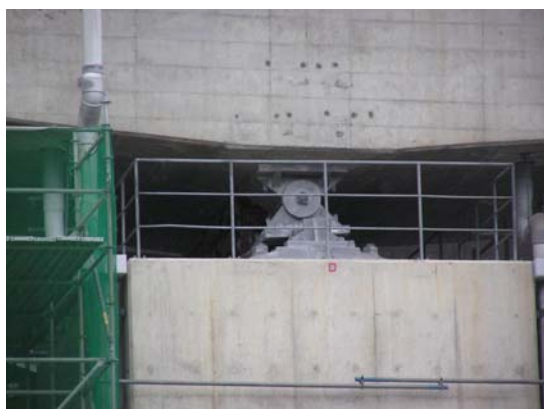
写真-5.36 関越道：橋脚部の変状（シュウのずれ）
