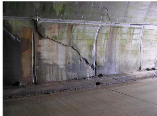
写真-5.20 荒谷トンネル坑口部のせん断クラック
