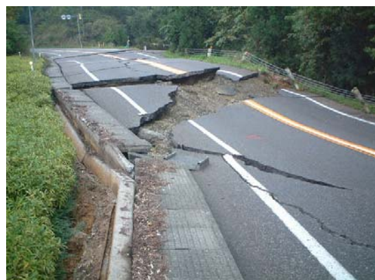
写真-5.6 道351号宮路町付近の道路切盛境界にて発生した道路盛土のすべりによる崩壊
