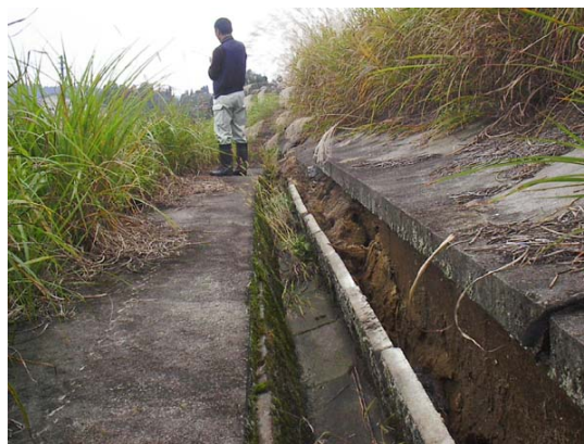
写真-5.34 関越道：小段に認められる盛土すべり
