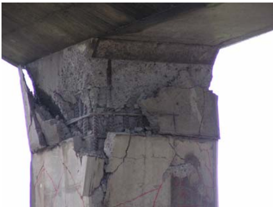
写真-5.16 長岡市内新幹線橋脚のコンクリート圧壊 （上・下部工打継ぎ目上部のコンクリート圧壊が顕著）
