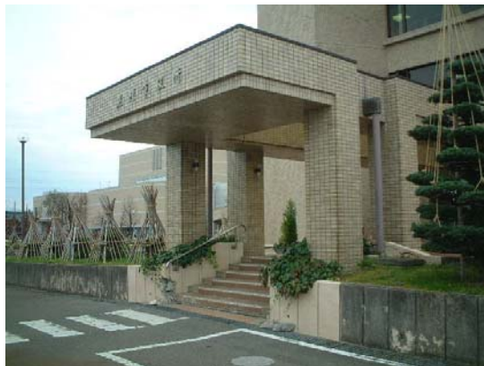
写真-5.1 見附市役所基礎の液状化，建屋基部のクラック
