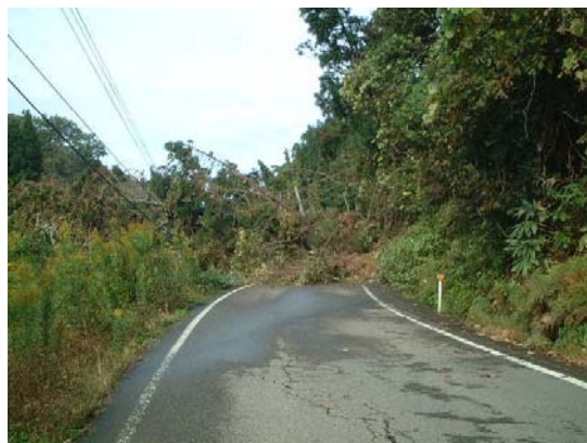
写真-5.11 主要地方道72号道路斜面の表層すべり
