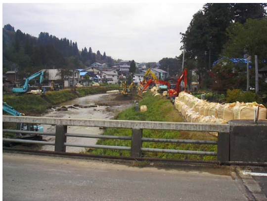
写真-5.38 液状化による堤体沈下と応急対策
