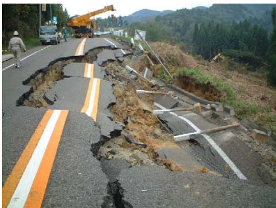
写真-5.7 国道351号宮路町付近のすべりによる崩壊
