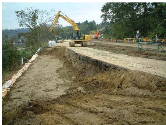
写真-5.3 見附市内の道路拡幅盛土部分のすべり崩壊
