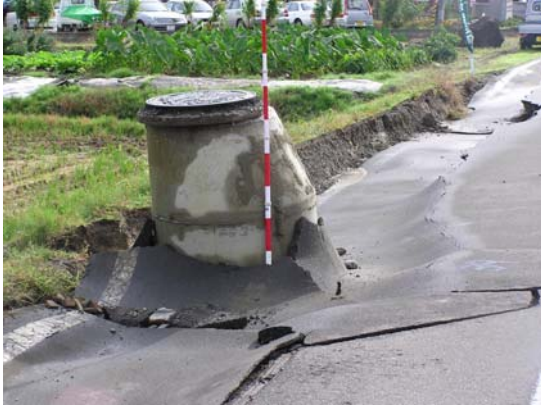
写真-5.15 液状化によるマンホールの浮上り：最大1.2m （J R上越新幹線の脱線停止箇所付近）
