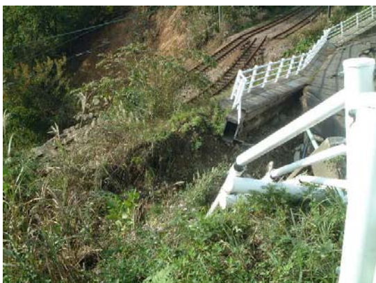
写真-5.24 J R上越線のすべりによる崩壊
