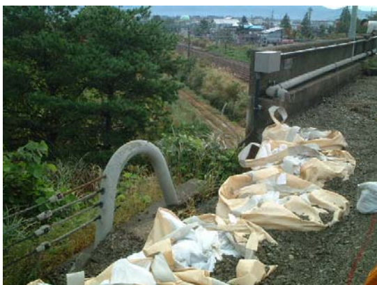
写真-5.10 来迎寺ともえが丘跨線橋背面盛土の沈下
