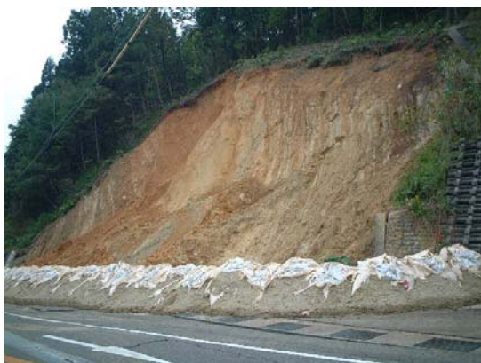
写真-5.9 国道351号宮路町付近の道路斜面表層すべり
