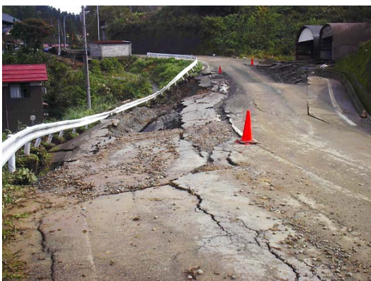
写真-5.31 道路盛土の崩壊・欠損
