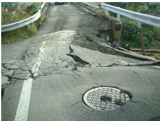
写真-5.28 川口地区橋台背面盛土の沈下
