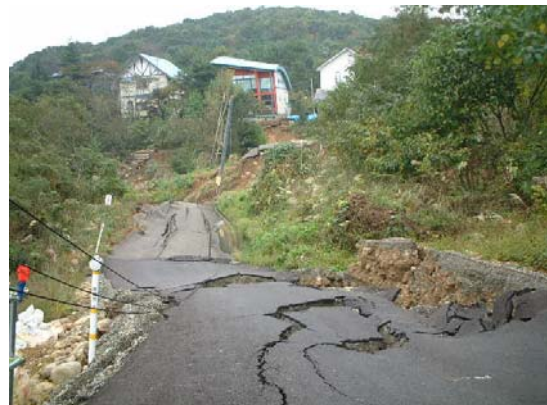
写真-5.5 へら鮎池周辺斜面のすべりによる崩壊
