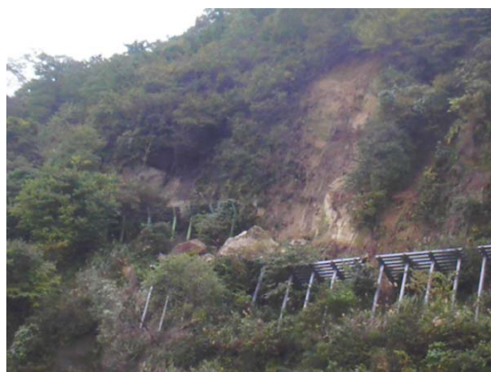
写真-5.40 なだれ予防柵への岩盤トップリング崩壊
