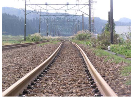
写真-5.18 長岡市J R上越線越後滝谷駅付近の液状化による軌道の変状（凹凸の高低差 50～80cm）
