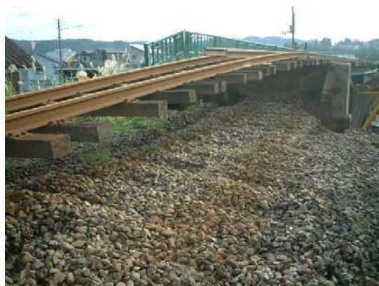
写真-5.27 J R飯山線川口地区橋台盛土の沈下・浮き
