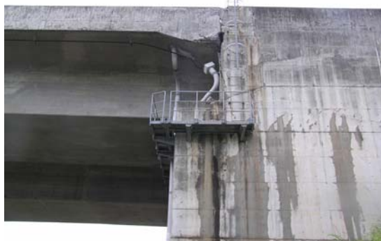
写真-5.35 関越道：橋台パラペットと上部工が接触
