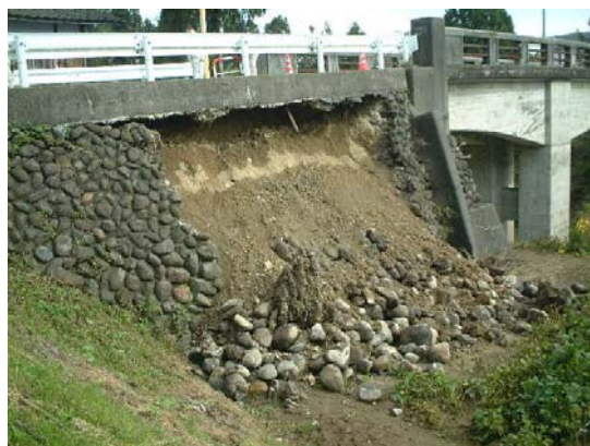
写真-5.13 主要地方道11号塚山橋橋台背面盛土の崩壊
