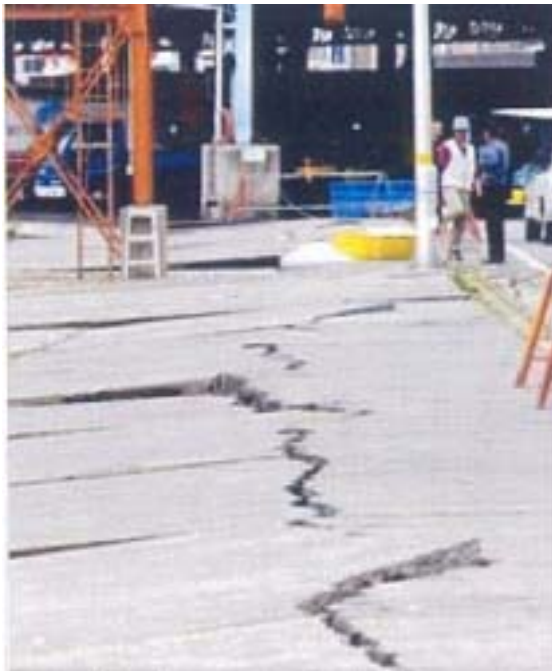
図-6.14 大船渡港野々田ふ頭岸壁に生じたクラック
