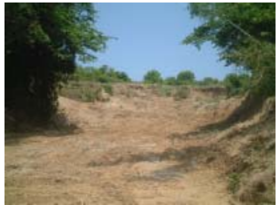
図-6.10 緩斜面の土砂崩れの状況
