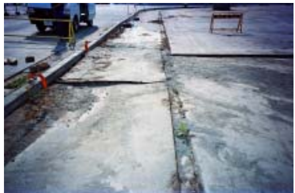
図-6.17 大船渡港 液状化による噴砂跡
